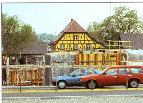
Das historische Wernerbof-Gebäude wird nach Ende der Bauarbeiten durch den Tunnel geschützt.
