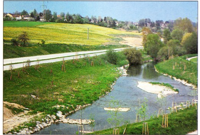
Schussenverlegung mit neuer Bepflanzung. Ausgleichsmaßnahmen sind bereits sichtbar, bevor der Verkehr rollt.
